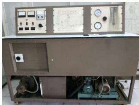
Gambar 3 : Unit mesin pengkondisian udara jenis Cussons Technology dengan serial nomor 129 OnWard (Sumber: Laboratorium Prestasi Mesin, Teknik Mesin, Universitas Merdeka Malang)
