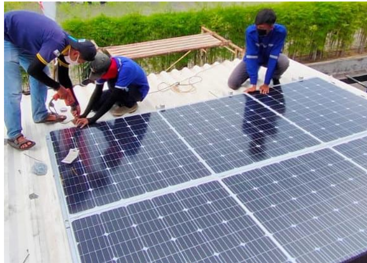
Gambar 9. Project solar panel atau panel Surya PT.AMI
