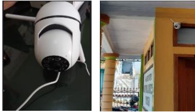
Gambar 5. Pemasangan Kamera CCTV PTZ outdoor di halaman depan Kantor Desa
